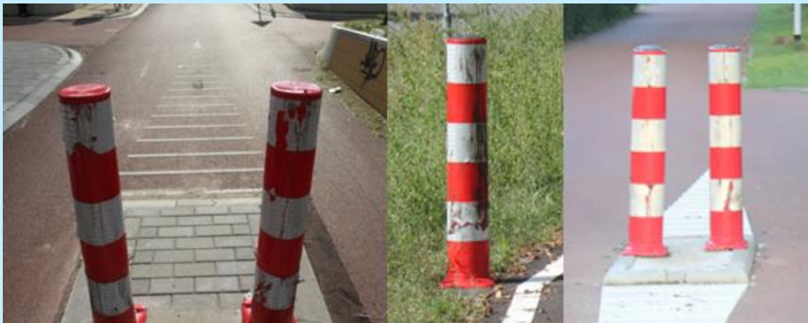
Figuur 8 Beschadigen op overrijdbare palen in Barneveld (links), Hardenberg (midden) en Houten (rechts).
