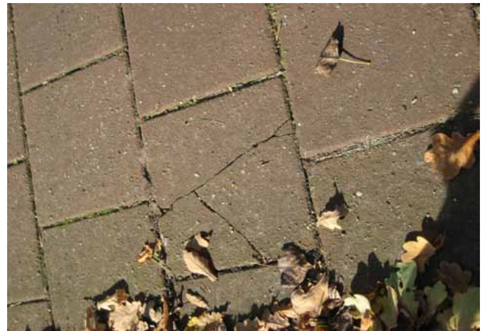
Foto 8: Bij met name tegelpaden is sprake breuk/slijtage.
