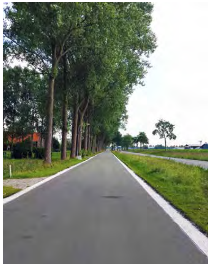
In Groningen en Friesland onderzoekt men het effect van bermstroken van reflecterende steenslag (Luxovit).
